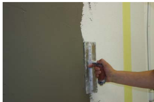
Effects Silikalk Tonachello opbrengen met een roestvaststalen spaan, met in elkaar overlappende spaanslagen.
